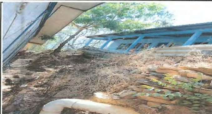
Foto1: Módulo de tres aulas corren el riesgo de derrumbarse.
