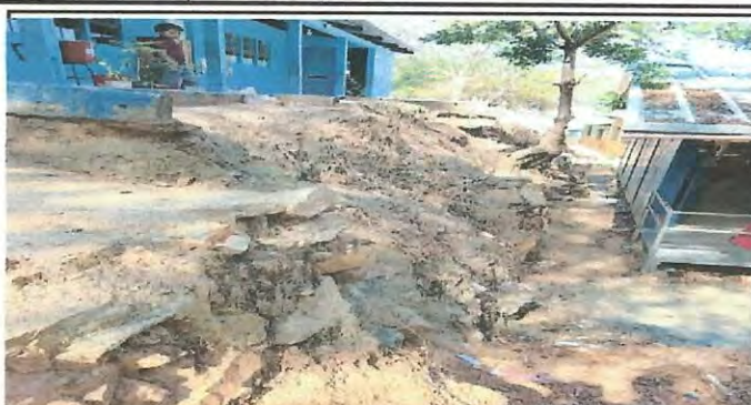
Foto 2: Módulo de aula del Nivel Preprimario corre riesgo de ser destruída en caso se deslice el paredón.
